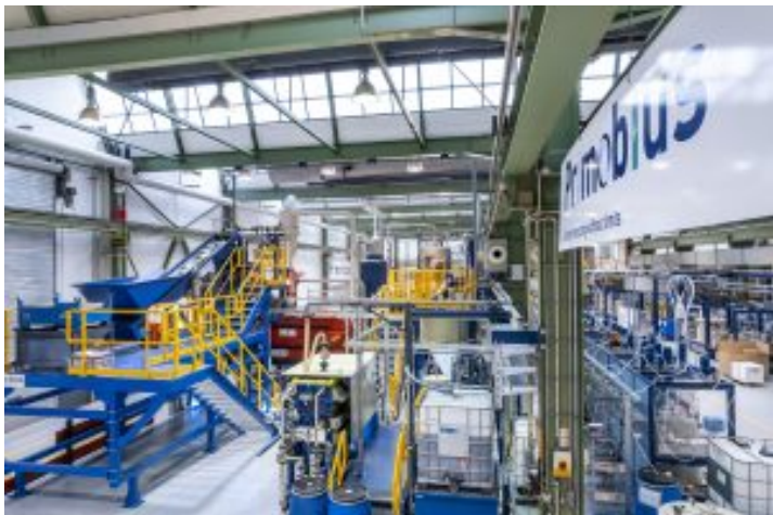
Primobius Werkstoff Hilchenbach Plant, Germany
